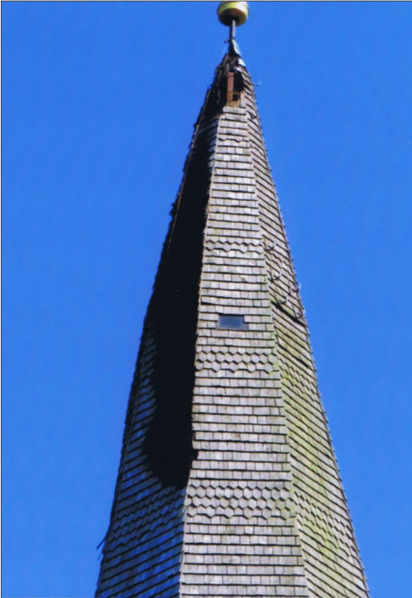
Die Schäden am Turm sind beträchtlich. Die Brandstellen wurden sogleich abgedichtet. (Foto: Rolf Pohlmeier)
